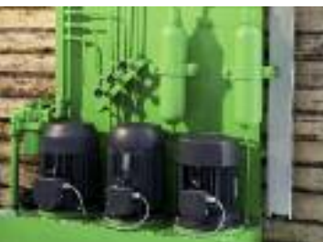
Eine leistungsfähige Hydraulikanlage mit Druckspeicher gewährleistet ein ordnungsgemäßes Abfahren bei Netzausfall oder Störung.
