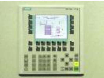
Über ein Tableau mit Display und Tastatur werden alle Prozessabläufe für Kran, Trockner und Vergaser gesteuert.
