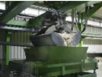
Die Beschickung des Reaktors erfolgt abhängig vom Füllstand über eine Vibrationsrinne und Schleusen-deckel.
