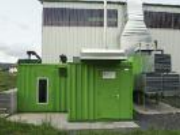
Steuerung, BHKW und Erhitzerteil des Trockners sind kompakt im Außenbereich der Anlage angeordnet.
